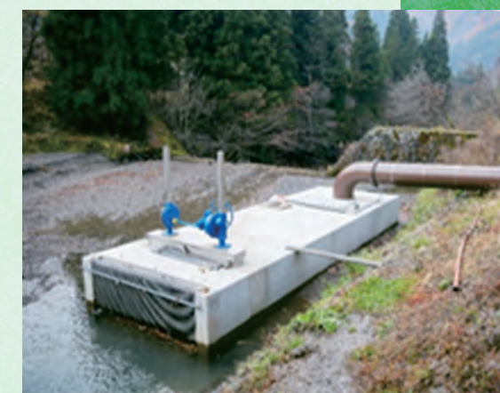
岐阜県高山市の小水力発電施設
