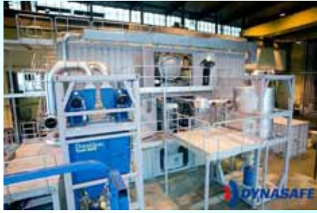
加熱燃焼炉(実機:Swedenでの作動試験時)
