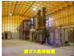
排ガス洗浄装置
