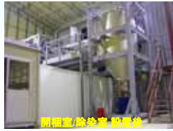
開梱室/除染室 設置後
