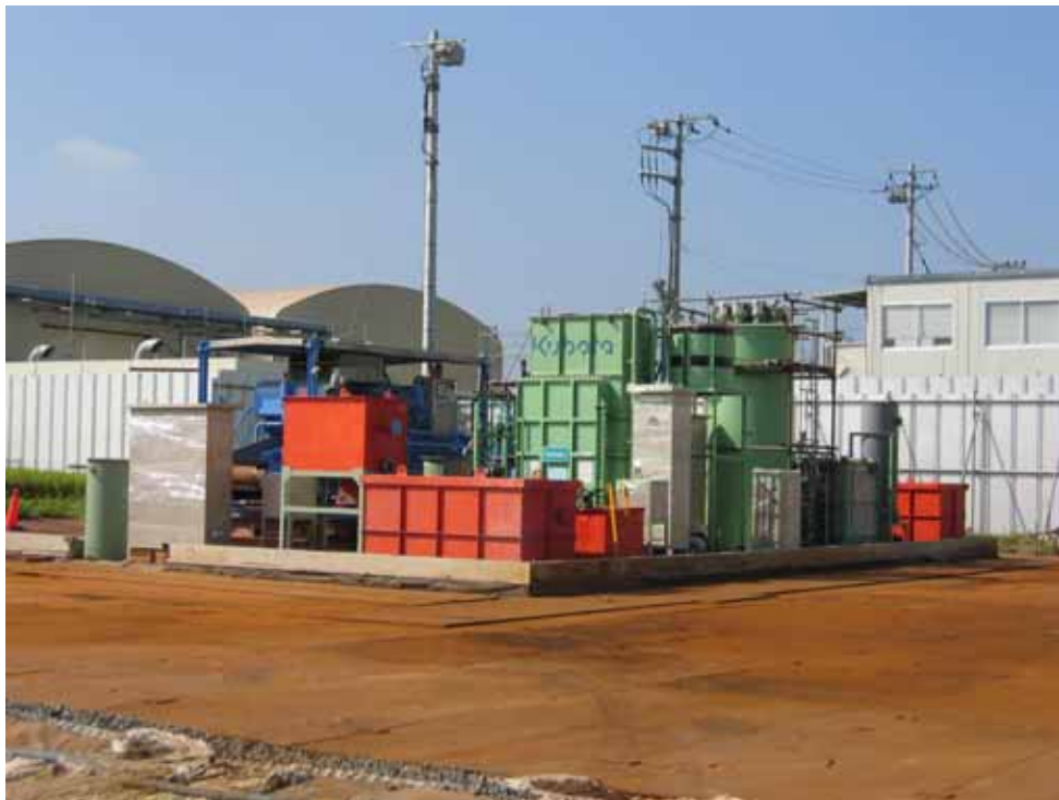
屋根と壁が解体・撤去された汚染地下水処理プラント(8月25日現在)
