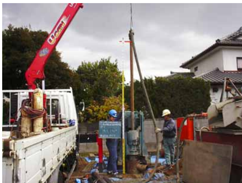
現在設置中のB地区揚水井戸
