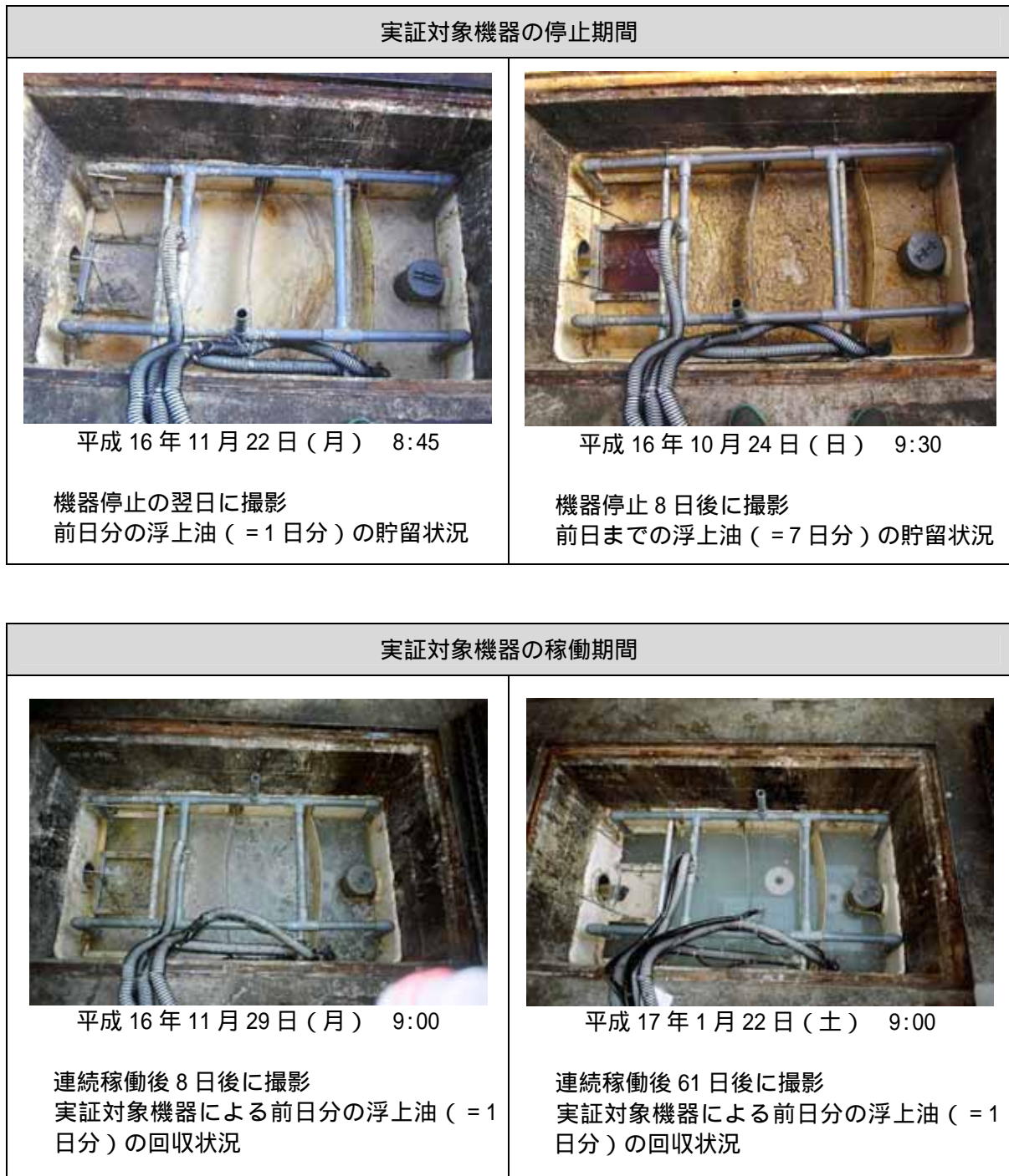
図4-11 グリストラップ内の浮上油発生状況
