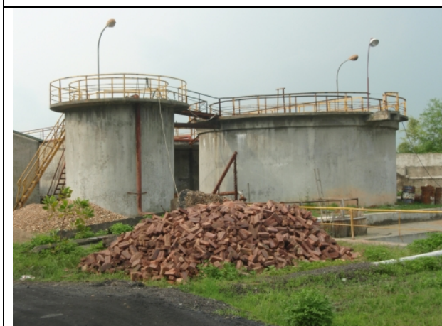
反応沈澱槽（未使用）
