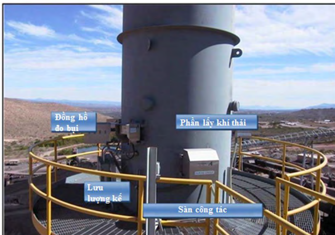
Hình 2.12. Ví dụ về việc lắp các thiết bị của CEMS vào phễu giữa ống khói
