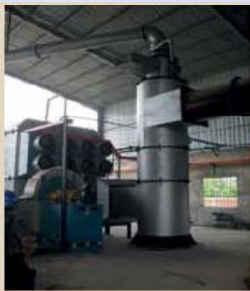
有害廃棄物燃焼装置の 排ガス処理システム
