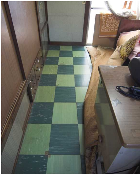
①石綿含有ビニル床タイル
