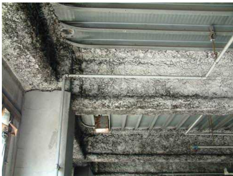
②石綿含有吹付けロックウール
