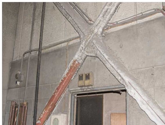
レベル 1: 吹付け石綿（クリソタイル）
