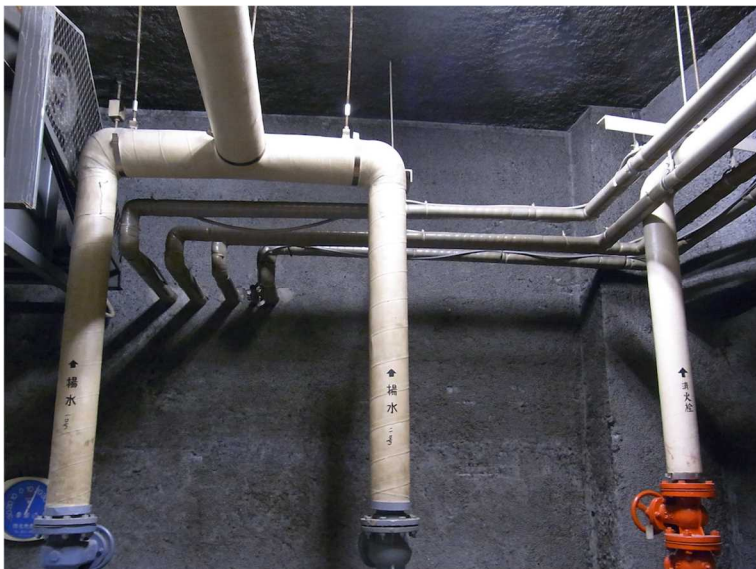
①吹付け石綿(クロシドライト)
