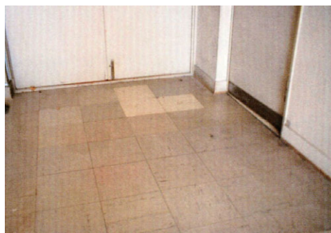
図 3. 107 石綿含有ビニール床タイル
