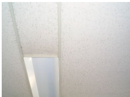
図 3. 106 石綿含有ロックウール吸音天井板
