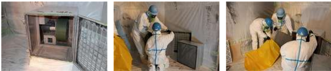
図 3.40 HEPAフィルタの交換
