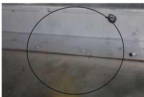
HEPA フィルタ取り付け面
