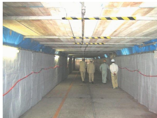
図 4.7.4 駐車場ビルにおける施工区画図 (車路の両側及び上部吊足場が施工区画)
