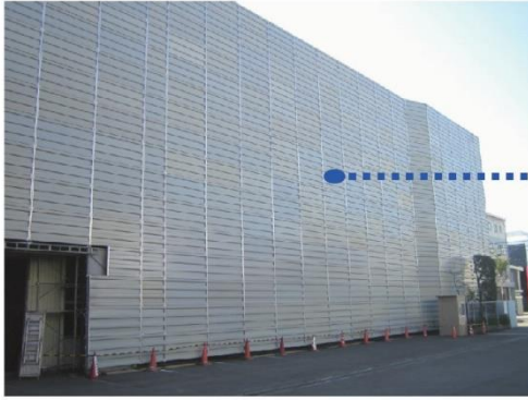
図 4.7.17 建屋周囲に設置した、通常の解体工事で使用する防音パネル（枠組足場に取り付け、内部の石綿除去工事を視覚的にも遮断）
