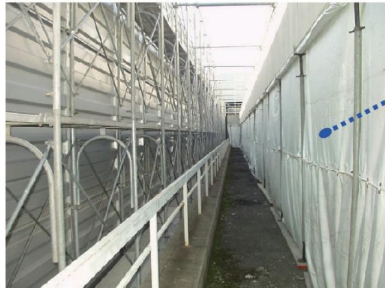
図 4.7.19 外壁開口部の飛散防止措置（開口部全面に防災シートを張った）
