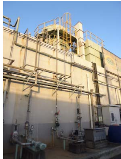
写真7 脱臭後の最終排気口
