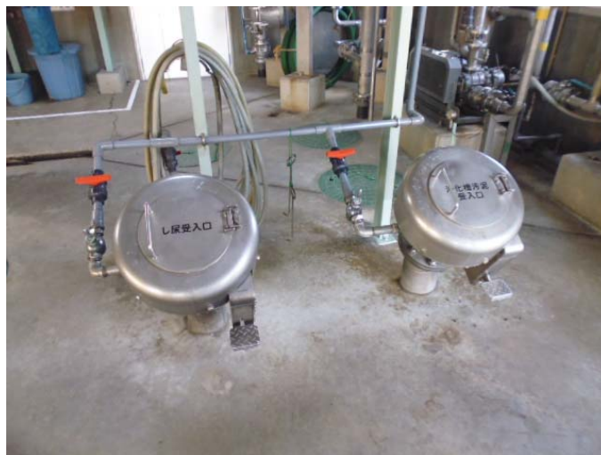
写真3 し尿（左）と浄化槽汚泥（右）の受入口
