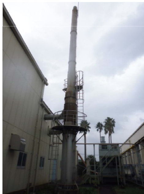
写真6 最終排気口（高さ 20.6m）
