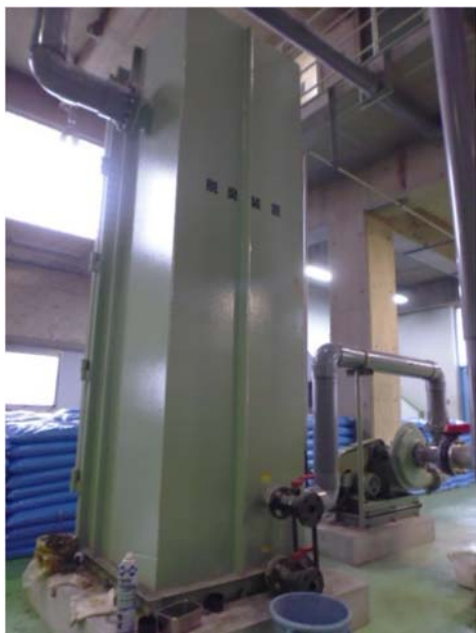
写真5 スクラバー脱臭装置
