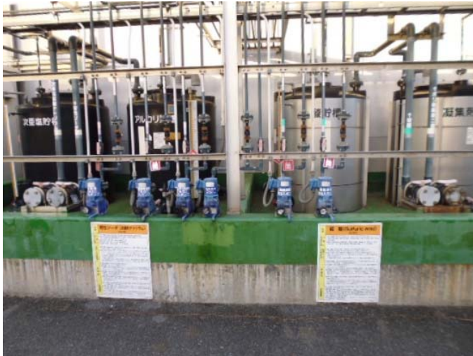
写真6 薬液脱臭装置のタンク
