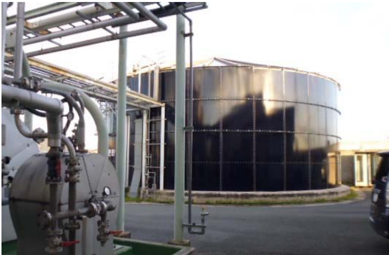
写真 1 液肥の貯留タンク
