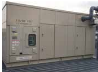
アンモニア冷媒冷凍機
