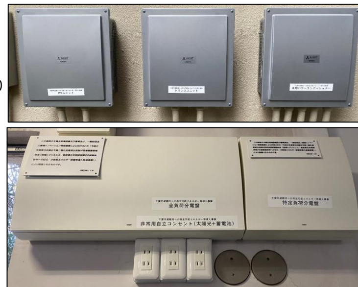
千葉市立千城台西中学校 設置設備 上段) パワーコンディショナ 下段) 非常用コンセント盤
