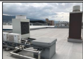
東大阪市東事業所 パネル設置箇所
