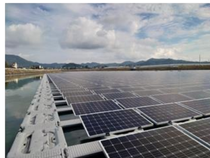
【水上設置架台】
