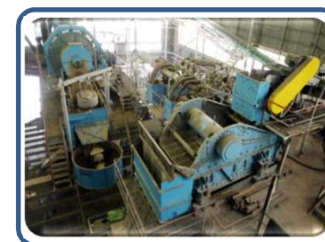
浄化等処理施設
