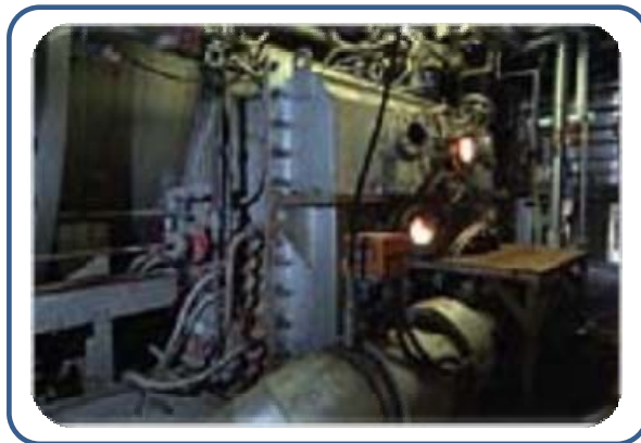
図 1.7-3 浄化施設（溶融処理）の例
