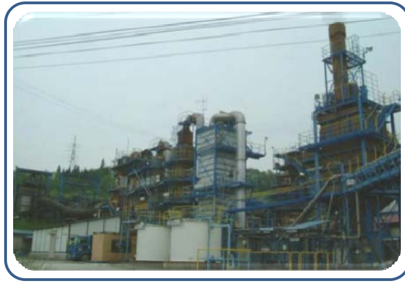
図 1.7-2 浄化施設（熱処理）の例
