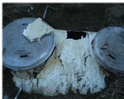
破損事例1：上部破損
