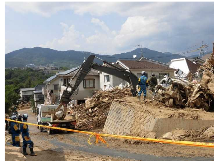
③ 損壊した家屋等の がれきの収集・運搬及び処分
