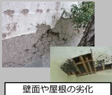
壁面や屋根の劣化
