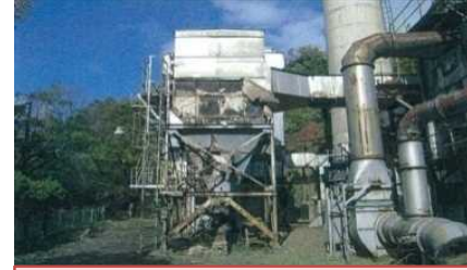
長期間稼働しているごみ焼却施設
