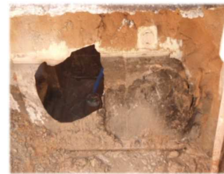
破損事例2：側部破損
