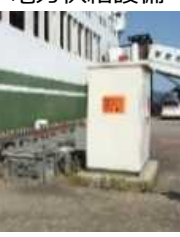
電力供給設備
