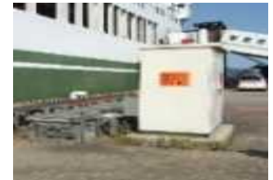
電力供給設備
