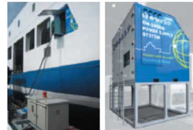
船舶側陸電受電設備
