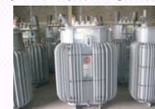
PCBが含まれる 高圧トランス
