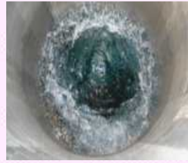
(熊本市) 水道水源井戸
