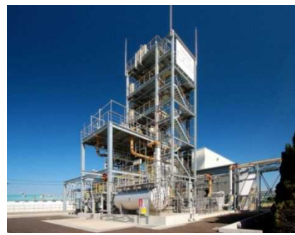
石炭火力発電所に設置された二酸化炭素分離回収設備
