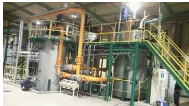
廃棄物等燃料製造装置
