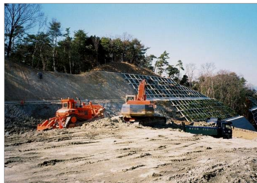
ブルドーザのリッパ掘削とバックホウによる掘削・積み込み作業
