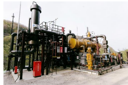
バイナリー式地熱発電所 (発電出力最大440kw)
