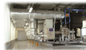
<中央方式冷凍冷蔵機器>
