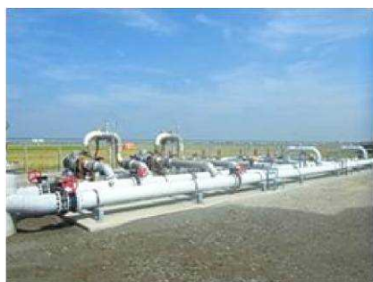
写真 1 かん水圧入基地 1)
