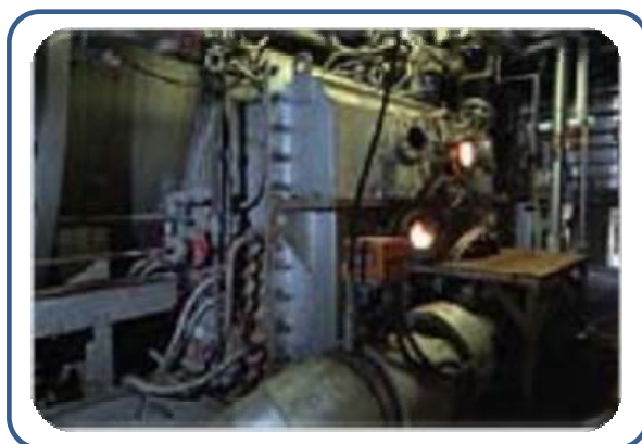
図 1.7-3 浄化施設（溶融処理）の例
