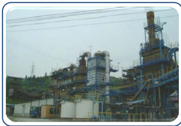
図 1.7-2 浄化施設（熱処理）の例
