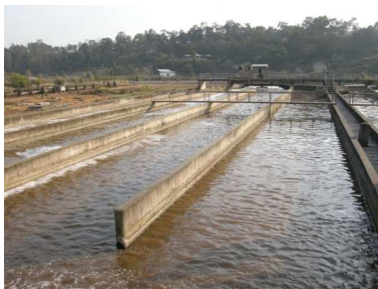
ネパール・カトマンズ市 (1.6万m 3 /日、OD法)
