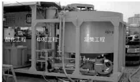
図 8-12 酸化、中和、凝集装置の概況写真
