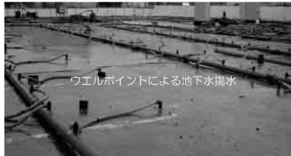
図 8-11 地下水揚水の概況写真
