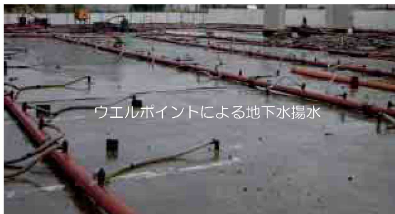
図 8-12 地下水揚水の概況写真
