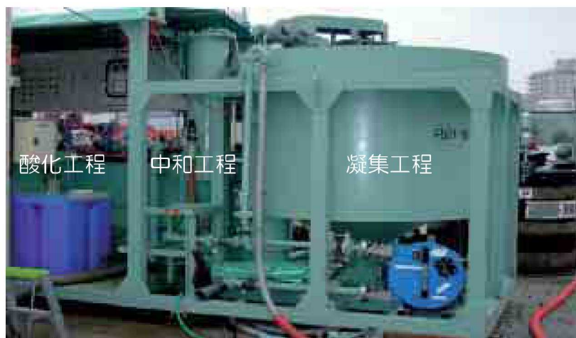
図 8-13 酸化、中和、凝集装置の概況写真
