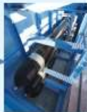
① 蓄圧器ユニット
