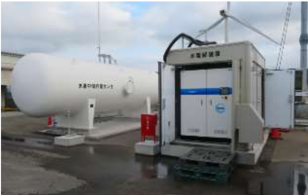
水電解装置 (10Nm 3 /h)
