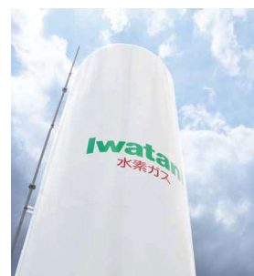
水素貯蔵タンク Hydrogen storage tank
