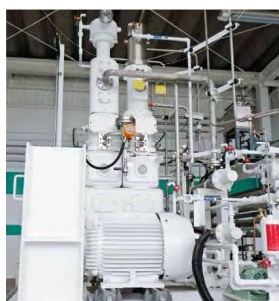
水素圧縮機 Hydrogen compressor
