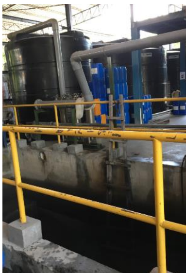
排水処理施設
