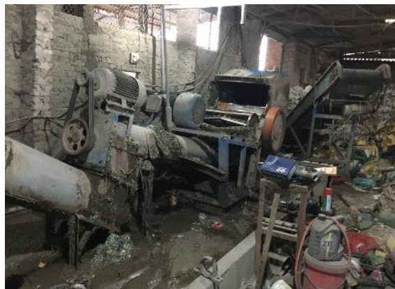
洗浄・破砕、ペレット加工
