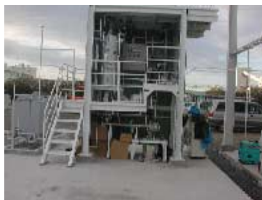
写真 3-1 炭素化分解・再生試験設備
