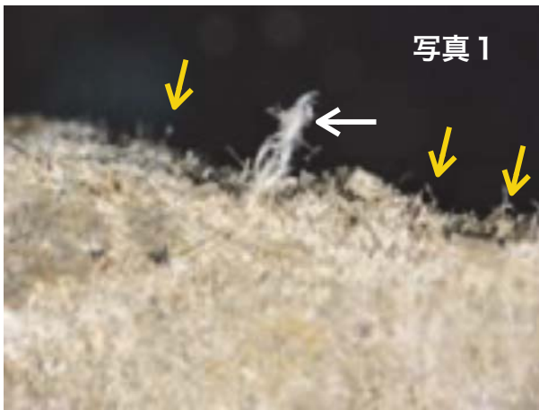
写真1 石綿含有あり スレート平板
