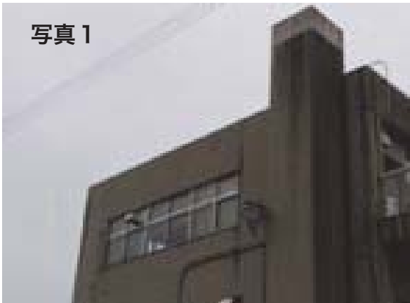
写真1 煙突用断熱材のある煙突
