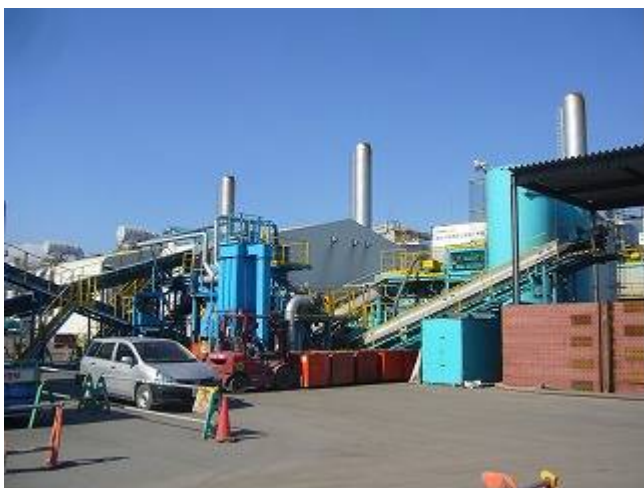
焼却灰の造粒固化設備
