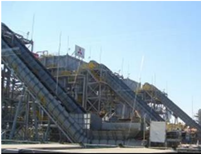
ストーカー炉 3 基
