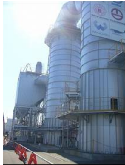
キルン炉の再燃焼炉、冷却塔、バグフィルタ
