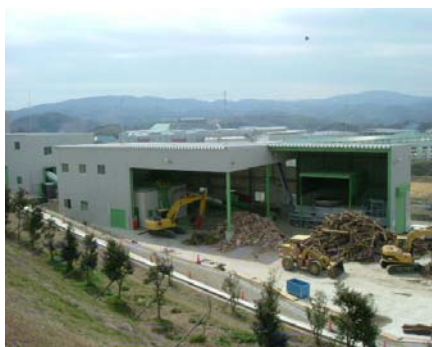
写真：木質系廃棄物破砕選別施設
