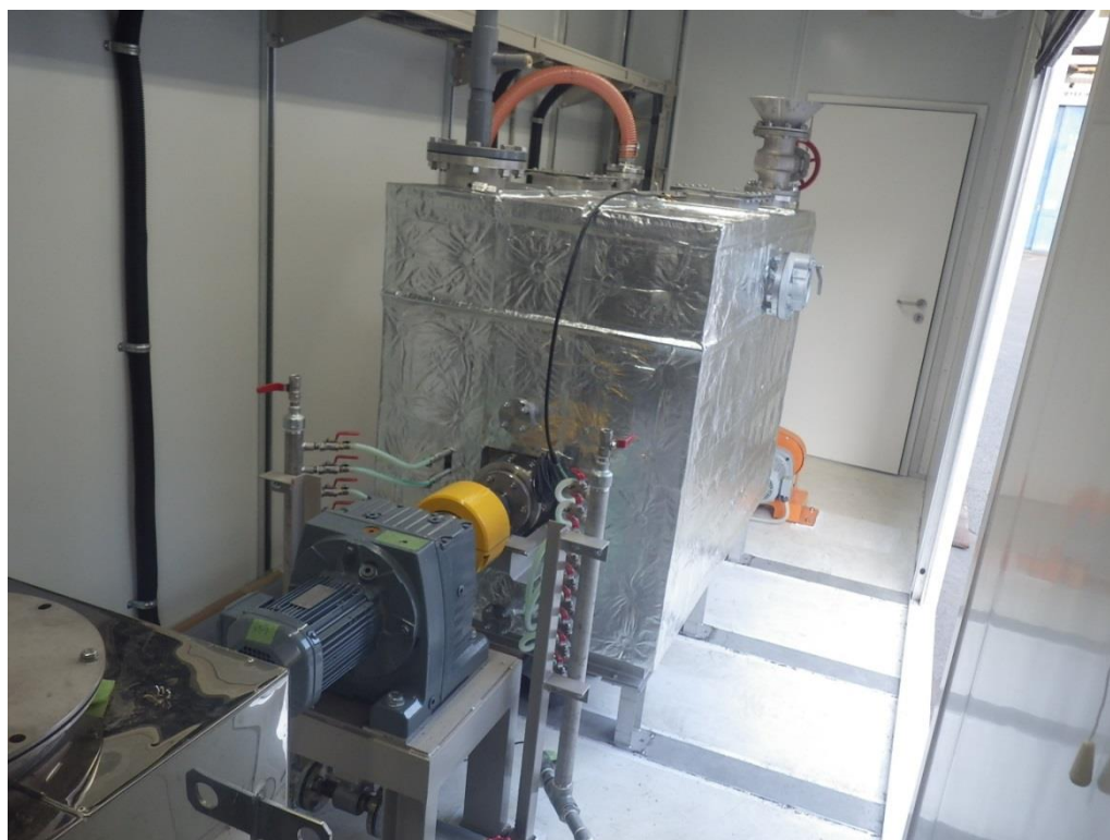
図 2.3-3 発酵槽の外観
