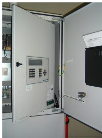
(Vestas 1.65MW 機制御装置)
