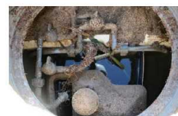
浄化槽内に土砂が流入した例
