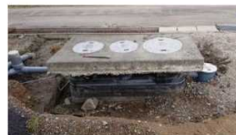
洪水により浄化槽が露出した例
