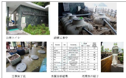
図 51 浄化槽の設置状況と処理水質
