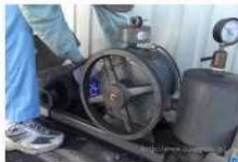
Kiểm tra trạng thái hoạt động của máy thổi
