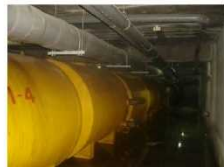
Tòa nhà Pacific, Hanoi 35 bể FRP
