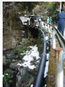
クイック配管(露出配管) (檜原村)
