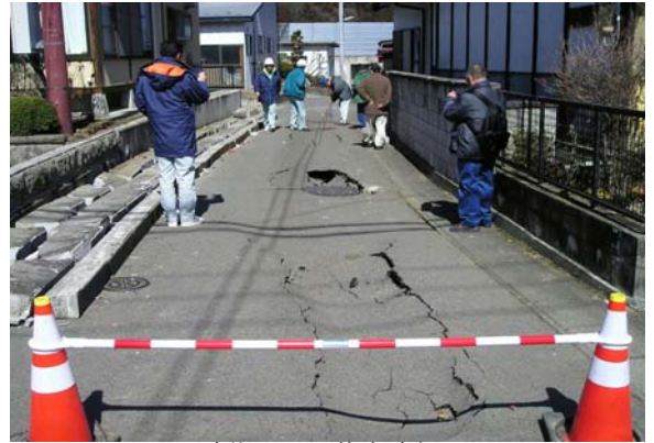
液状化により管路が陥没
