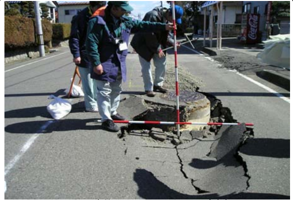
液状化によりマンホールが隆起
