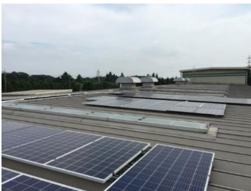
写真 2.2.4 PV モジュール (2)
