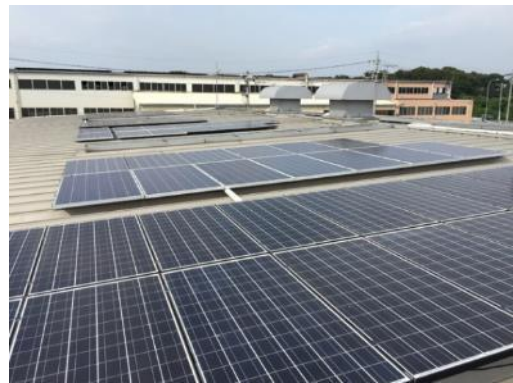
写真 2.2.3 PV モジュール (1)
