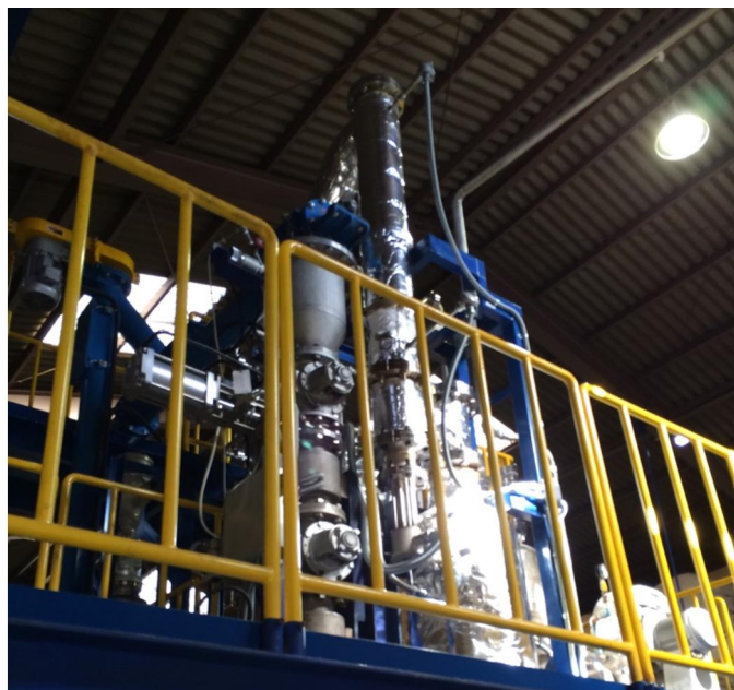
図 4-9 接触分解方式による油化プラントの還流塔
