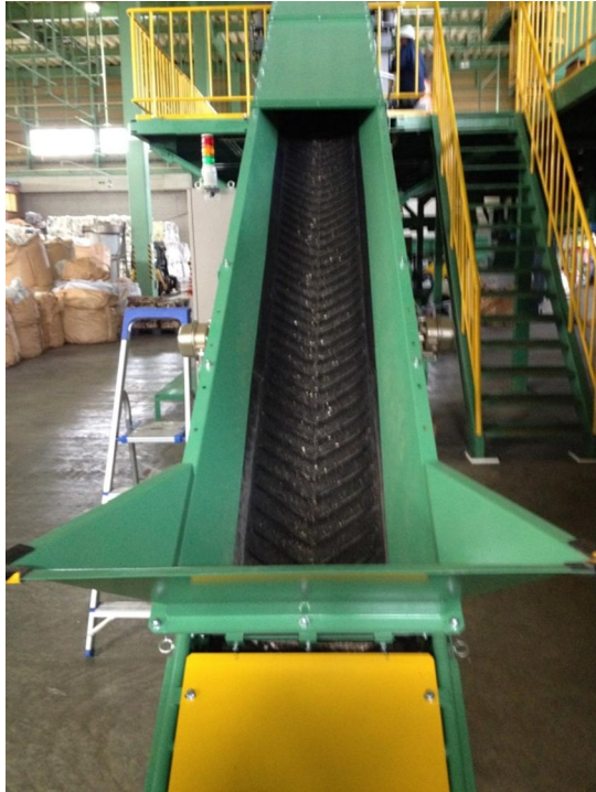
図 2-3 投入口と投入コンベア
